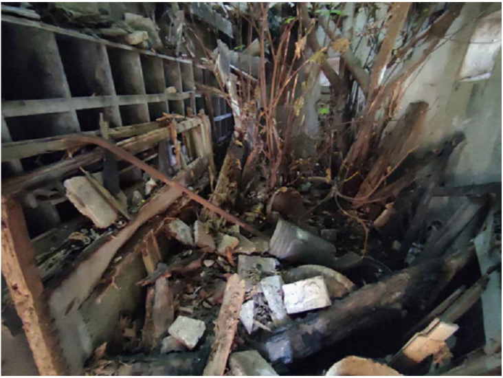
Foto 03. Interior torre, runa i brossa acumulada a la planta baixa.
