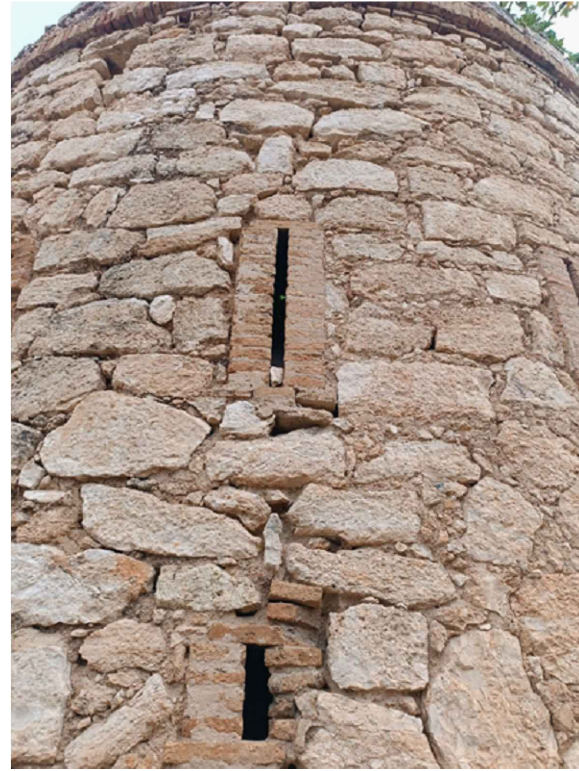
Foto 04. Totxos que configuren les espitlleres, degradats.
