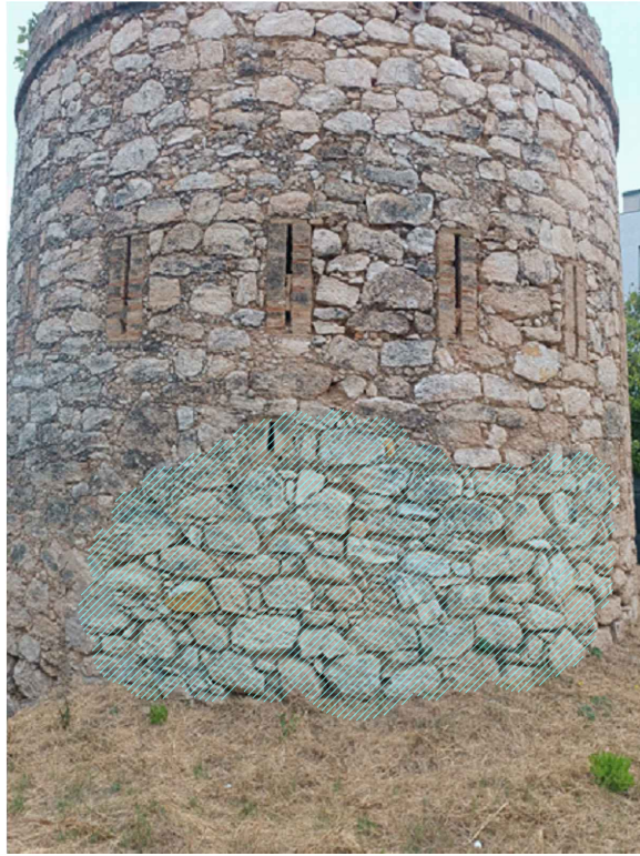
Foto 02. Manca material junt part baixa del mur de paredat de pedra i fang.
