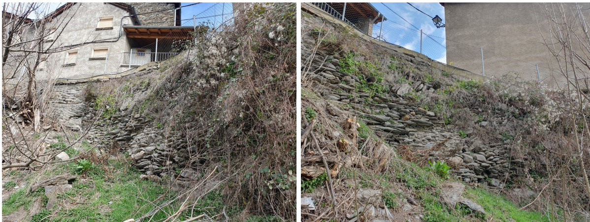
Actuació 06. Mur de pedra de sosteniment del carrer Arrabal en mal estat. Es considera el seu desmuntatge, la seva reconstrucció amb un reforç interior de formigó armat.
