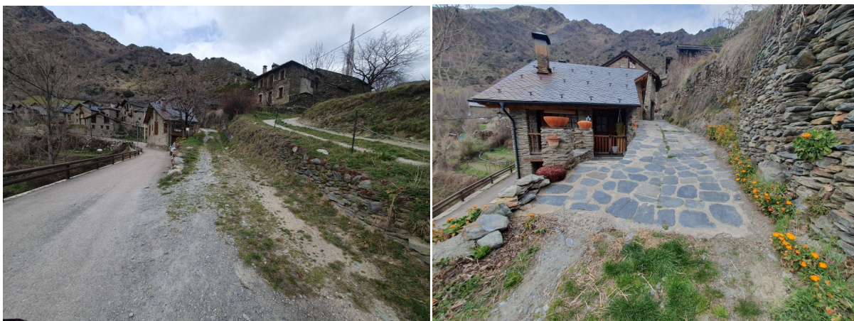
Actuació 07. Carrer sense pavimentar (esquerre) i tram de paviment a substituir (dreta).
