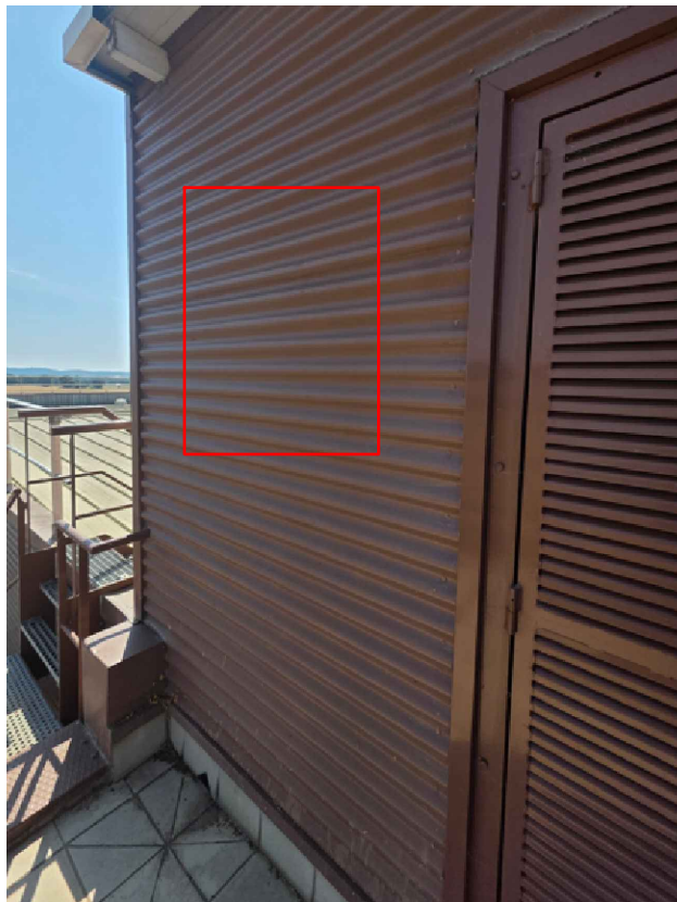
QUADRE PROTECCIONS DC UBICACIÓ FORA COSTAT PORTA ACCÉS A SALA MÀQUINES PLANTA DE DALT
