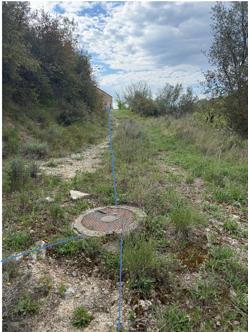
Arqueta on dona servei d'aigua a la casa
