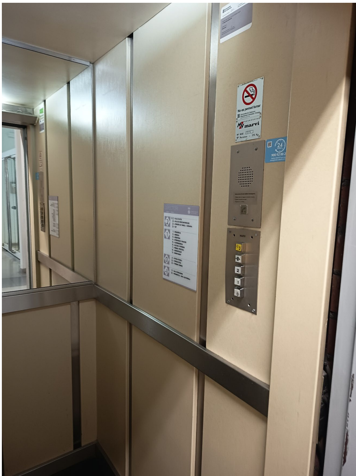
Fotografia núm. 12 – Detall de la botonera de l'ascensor de l'edifici del CCAU
