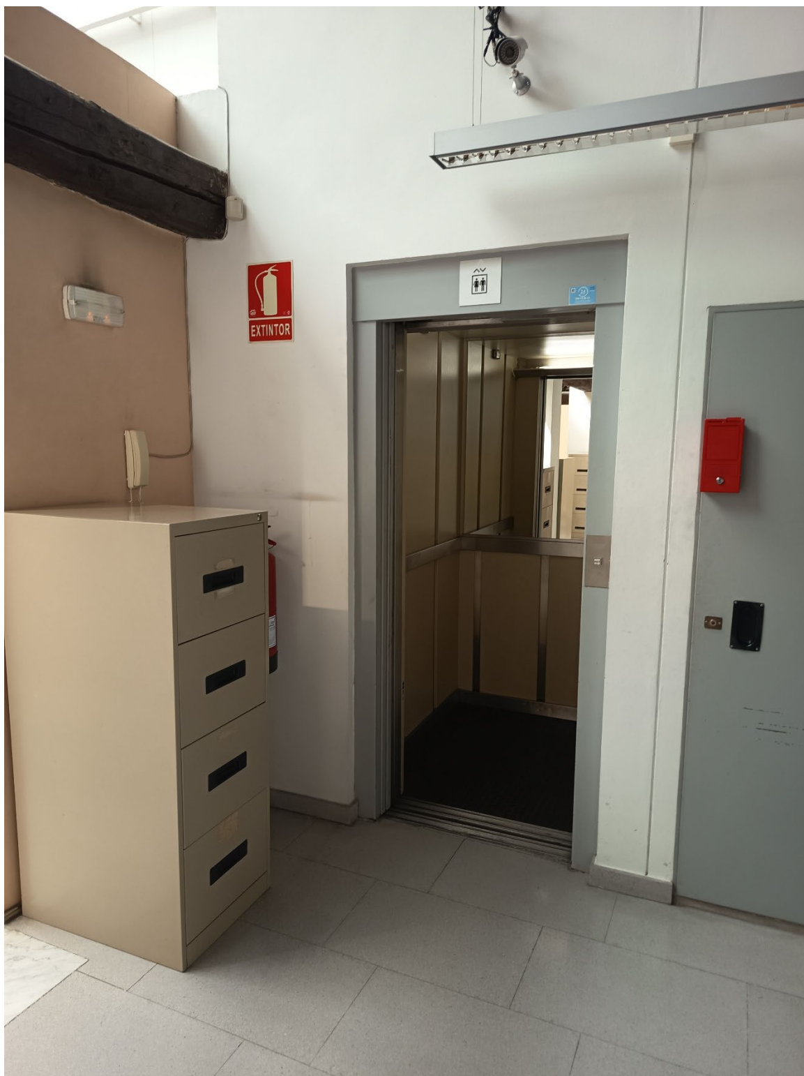
Fotografia núm. 10 – Porta de l'ascensor de planta segona de l'edifici CCAU.
