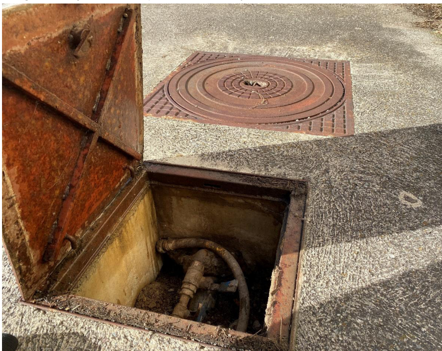
Imatge 2. Vista general de la captació del Pou de l'Ajuntament.
