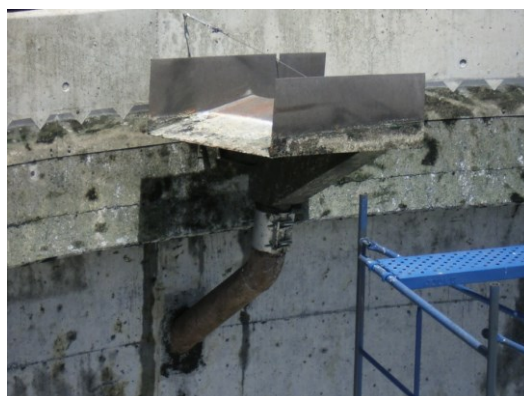
Detall dels elements de l'skimmer actual.
