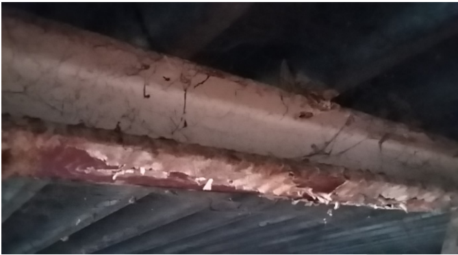
Antes de Limpieza
