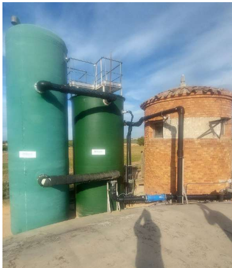
Fotografia 9. Filtres de sorra i caseta de l'ETAP.
