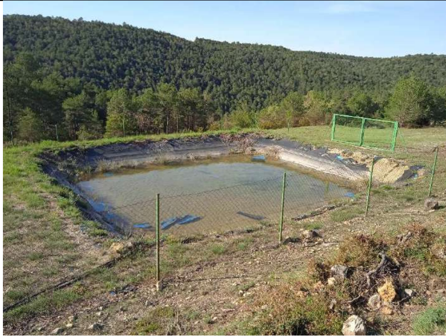
Punt d'aigua Bassa Mas de l'Isidre amb lona i conducció d'alimentació trencades
