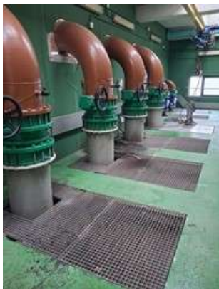
Bombes recirculació externa
