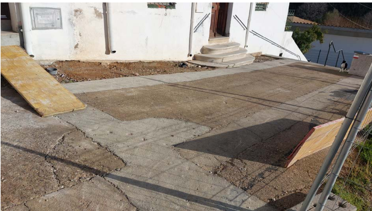
Paviment de formigó en mal estat i manca al final del C/Església
