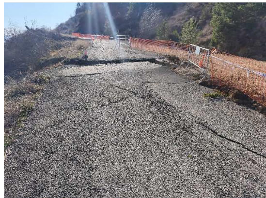
Imatge 03. Estat actual de l'enfonsament de la carretera d'accés a Gurp, primer tram de l'actuació I, en la zona de l'obra de drenatge.
