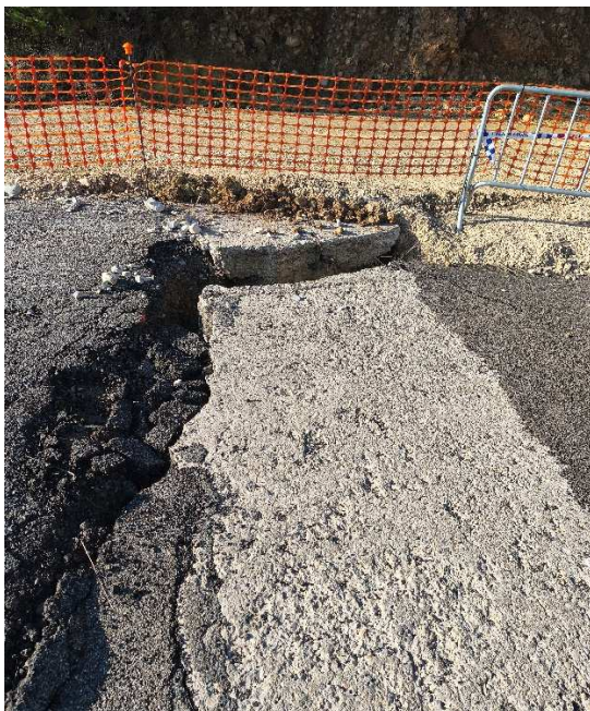
Imatge 04. Estat actual de l'enfonsament de la carretera d'accés a Gurp, primer tram de l'actuació I, en la zona de l'obra de drenatge.
