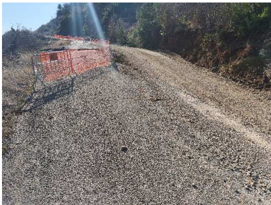
Imatge 02. Estat actual de l'enfonsament de la carretera d'accés a Gurp, primer tram de l'actuació I, en la zona de l'obra de drenatge.
