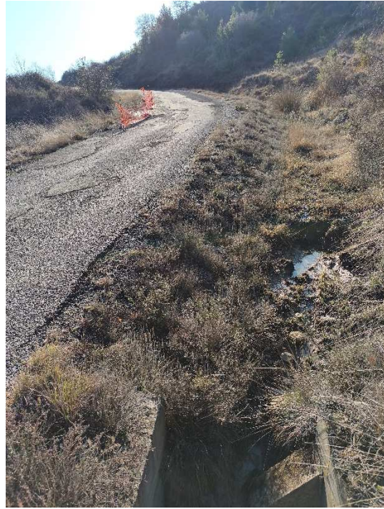
Imatge 07. Estat actual de l'enfondrament de la carretera d'accés a Gurp, en l'actuació II.
