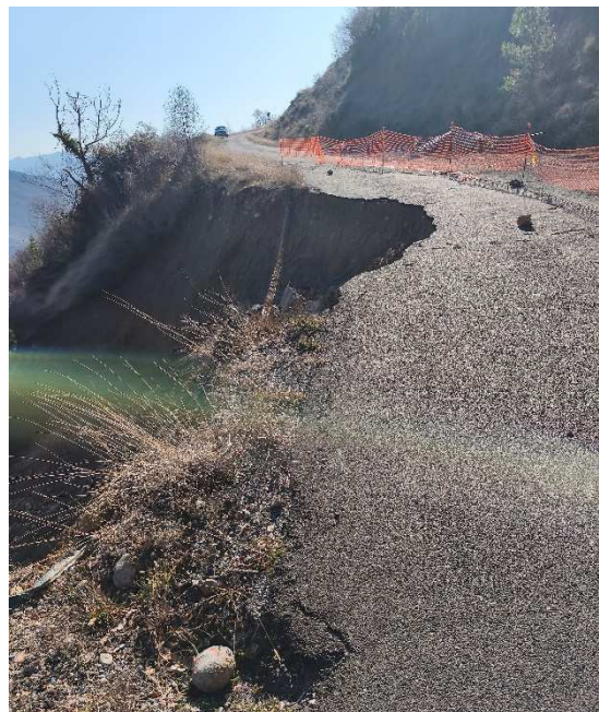
Imatge 05. Estat actual de l'enfonsament de la carretera d'accés a Gurp, segon tram de l'actuació I, en la zona on ha quedat al descobert la fibra òptica
