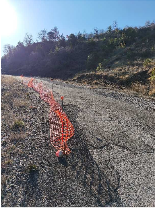
Imatge 06. Estat actual de l'enfondrament de la carretera d'accés a Gurp, en l'actuació II.
