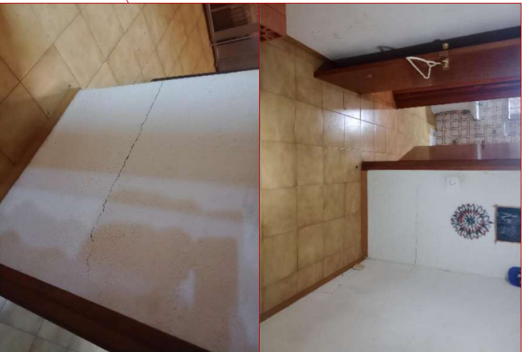
esquerda horitzontal a l'alçada de mig metre aproximadament a la divisòria de fàbrica de maó de 5 cm de gruix que hi ha entre el dormitori 1 i la sala d'estar-menjador.
