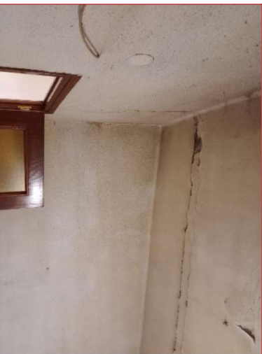
Esquerda en el forjat inclinat que aparentment marca l'amplada de la bigueta del forjat. Aquest tipus d'esquerda es dona en altres llocs de l'habitatge però en aquesta bigueta és on més es veu i té continuïtat en forma d'esquerda vertical en la paret de maó.
