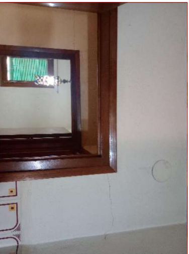
Fissura horitzontal a la zona de la part superior de la porta a la divisòria entre el dormitori 1 i el passadís i també a la divisòria entre la cuina i el passadís.
