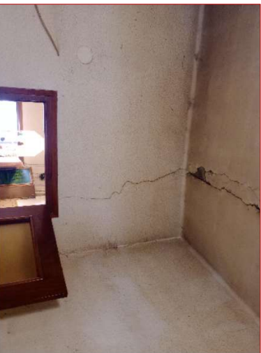
Esquerda vertical en la paret de fàbrica de maó de 5 cm de gruix que hi ha a sota de la bigueta. L'esquerda es pot veure per les dues cares de la paret.
