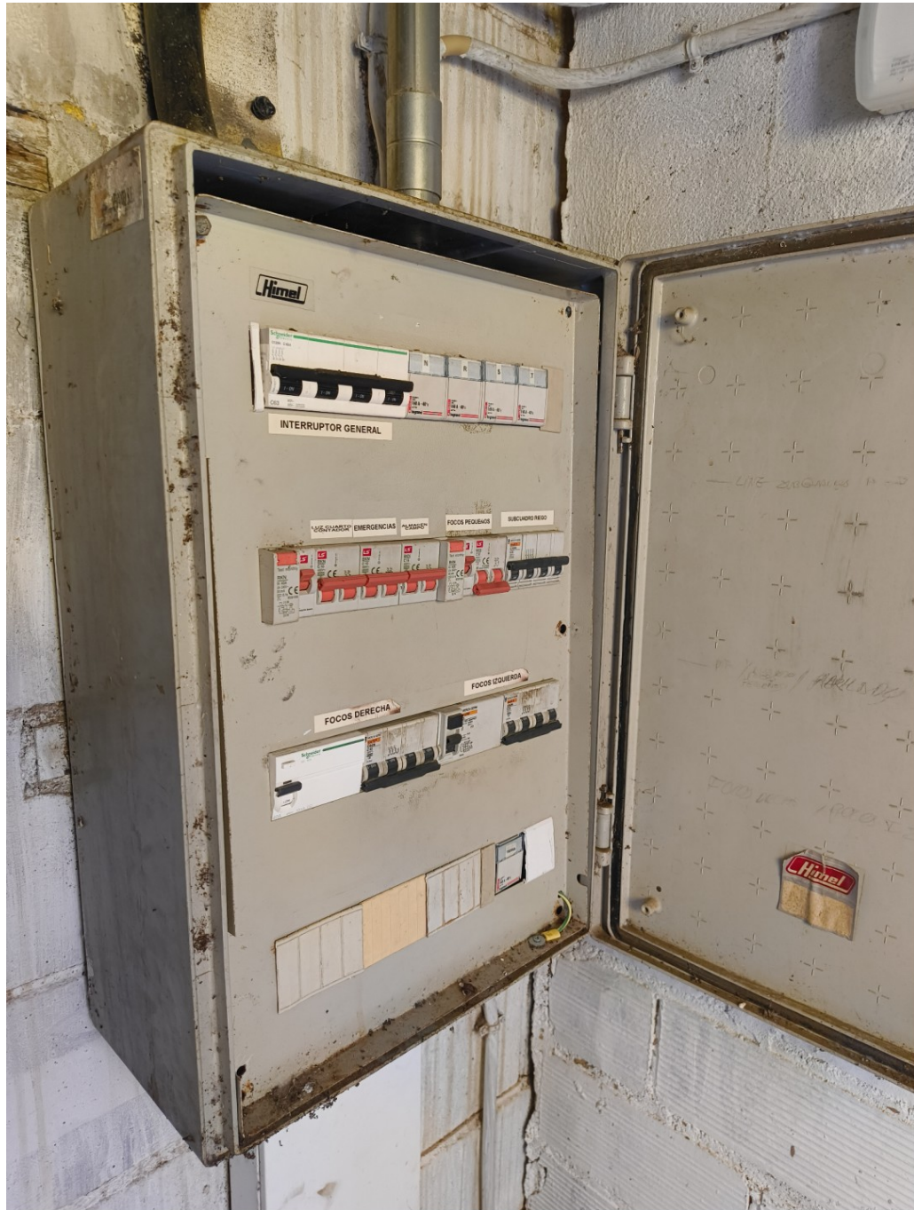
QUADRE ELÈCTRIC IL·LUMINACIÓ
