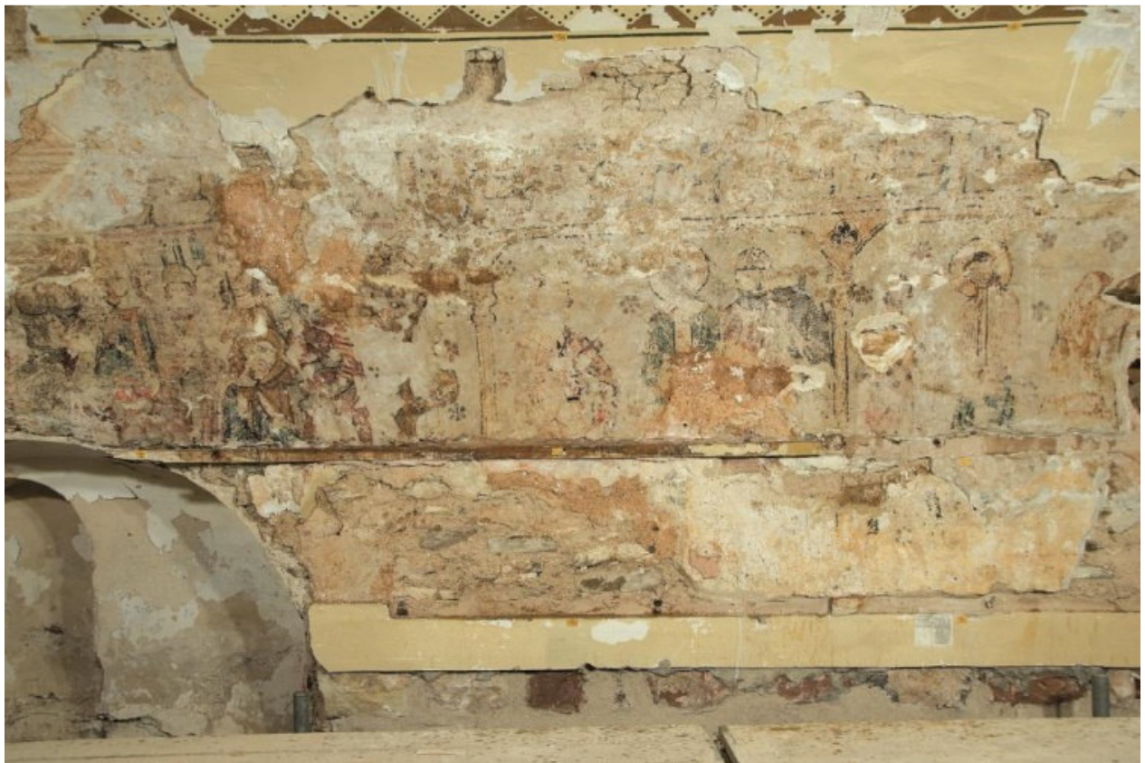
Pintures gòtiques del mur nord de la nau, en procés de descobriment sota capes d'estuc i pintura.
