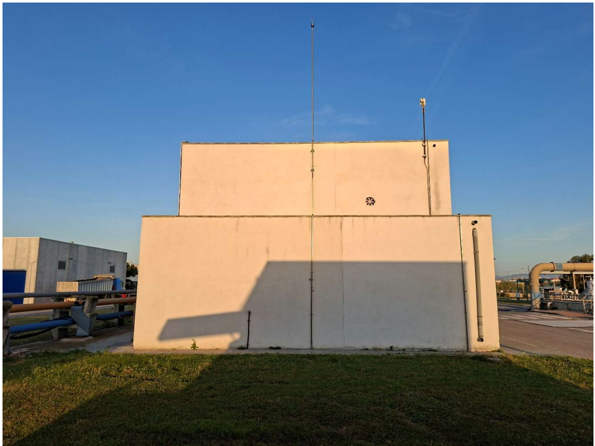
Il·lustració 2 Vista de la façana del CCM2, es pot observar que hi han dos canalitzacions i un punt d'aigua
