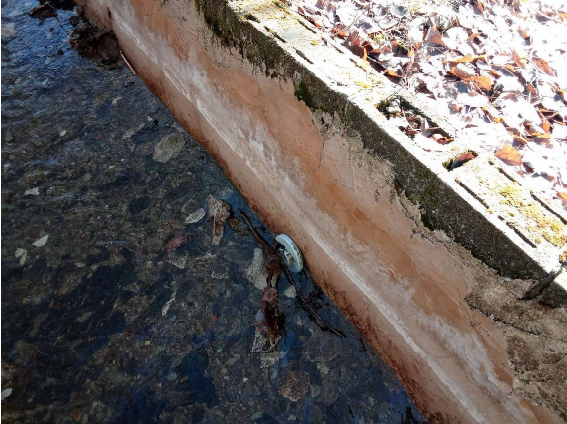
Foto 6.- Derivació aigua a la mínima expressió amb vàlvula de plàstic que dona sortida a una mànega de menys d'una ". També detall de barana lateral amb blocs amb enlluït de ràpid per evitar filtracions que cal substituir per nou caixó.
