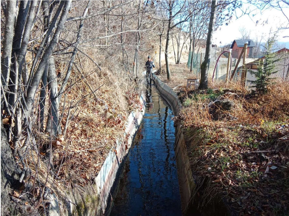
Foto 9.- A la fase 2, trams de canal de llauna a substituir completament.
