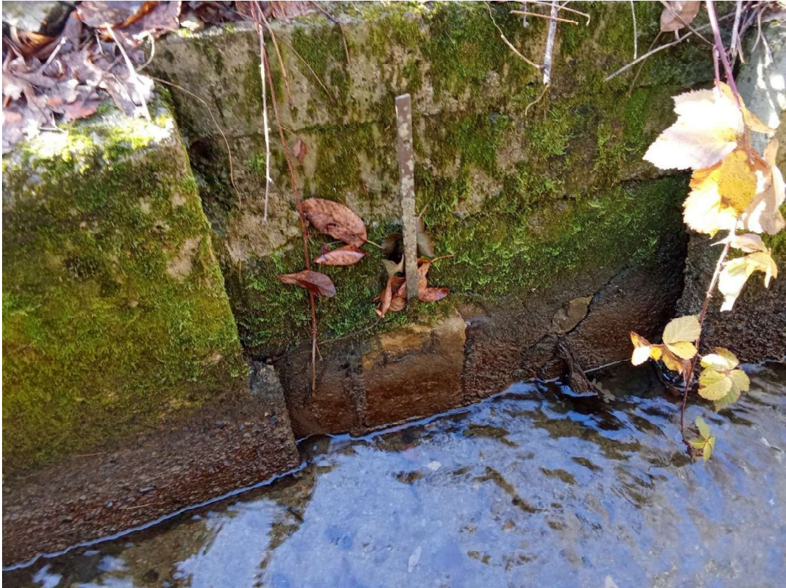
Foto 4.- que mostra una tramada on la barana que s'havia fet encofrada, ara deixa passar filtracions a l'estar esquarterada o mal connectada i, per tant, cal substituir-la fent el caixó de canal complet encara que en alguns trams que l'amplada ho permeti s'utilitzarà aquesta barana defectuosa com a cara d'encofrat per a la barana a realitzar del nou caixó.
