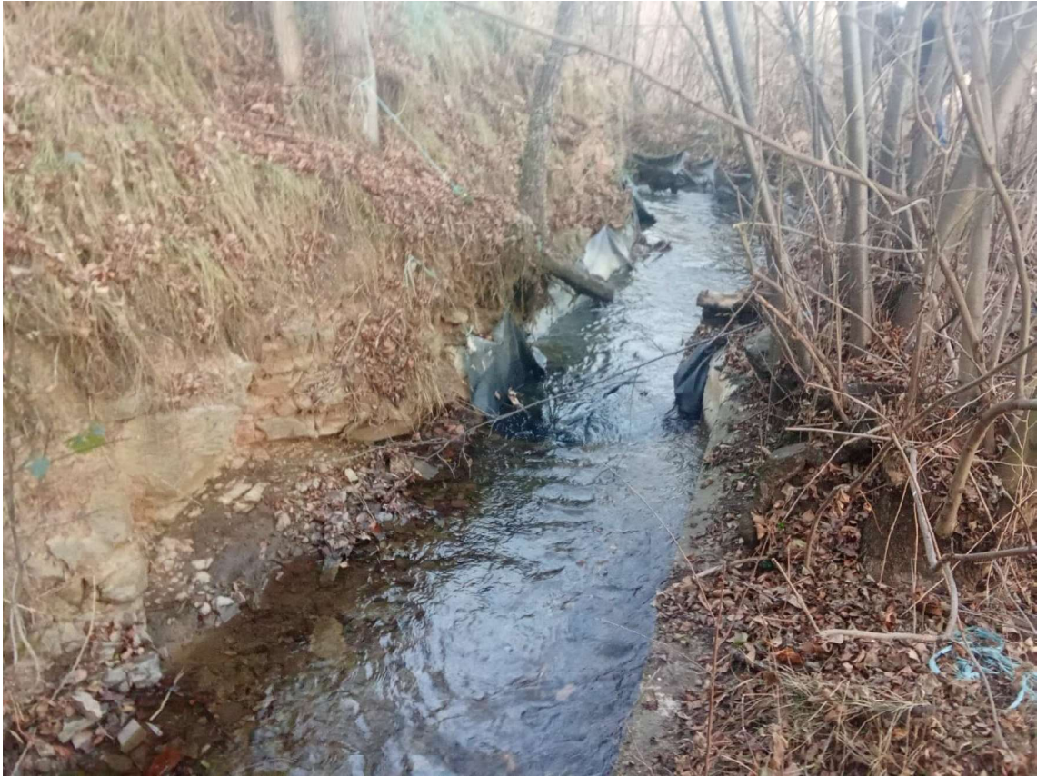
Foto 8.- Tram que cal fer completament veient-se a simple vista que existeixen filtracions en terreny molt porós malgrat un intent poc expeditiu d'intent d'impermeabilització amb trossos de plàstic.
