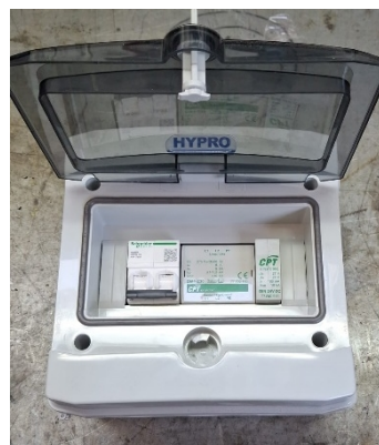
Foto 22. Mostra quadre proteccions
