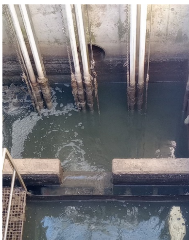
Fotos 19, 20 i 21: Imatges del pou sorrer on hi ha les 3 bombes submergides
