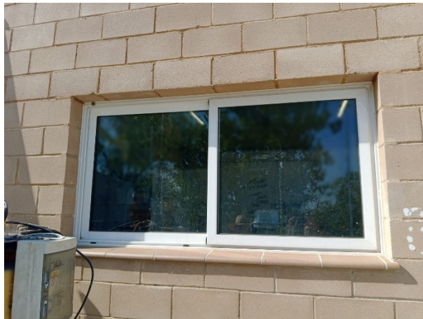
Foto 27: Finestra sala aigua de servei
