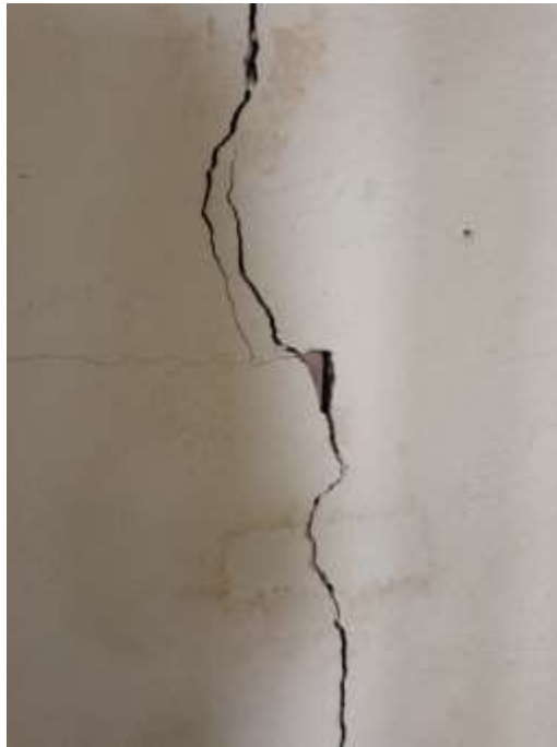
Esquerdas estructurals existents
