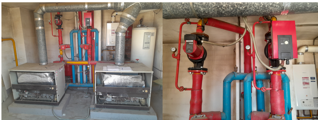
Fotografia. Calderes Atmosfèriques model NGC208 de la marca ROCA i grup de bombeig.
