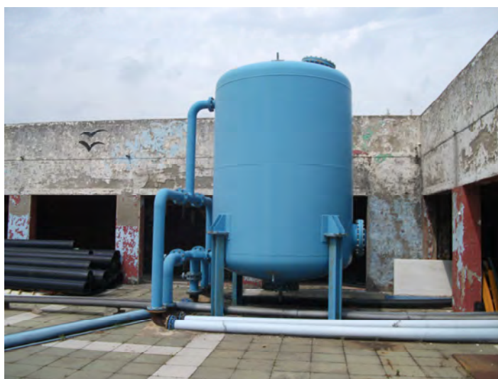
Connexions actuals del dipòsit.
