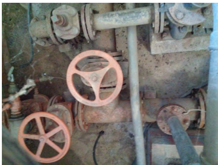
Vista de les re impulsions de Montornès Nord.
