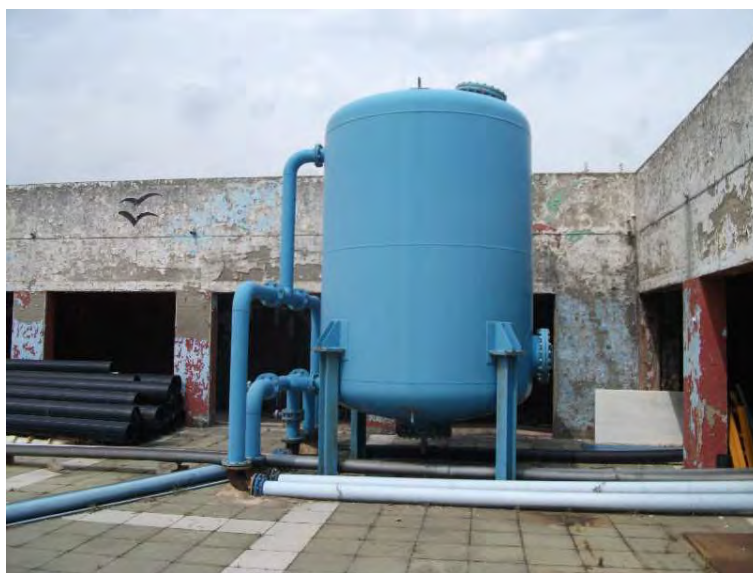
Connexions actuals del dipòsit.
