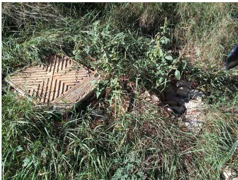
Vàlvula de la impulsió del POU 3 en el punt on es troba amb la canonada procedent del POU2.
