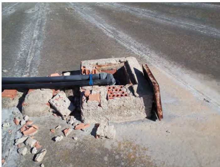
Arqueta de cloració.
