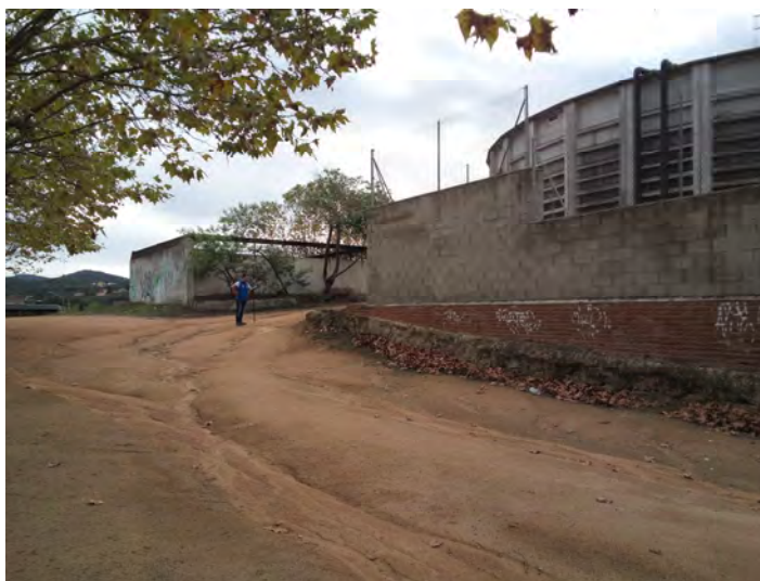
Mur a reforçar.
