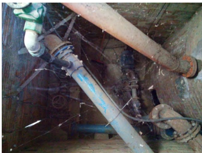
Vista de les canonades situades sota els quadre elèctrics.
