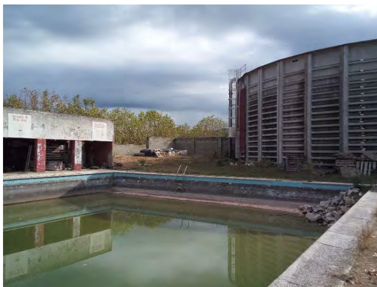
Muret de la piscina que cal reforçar.
