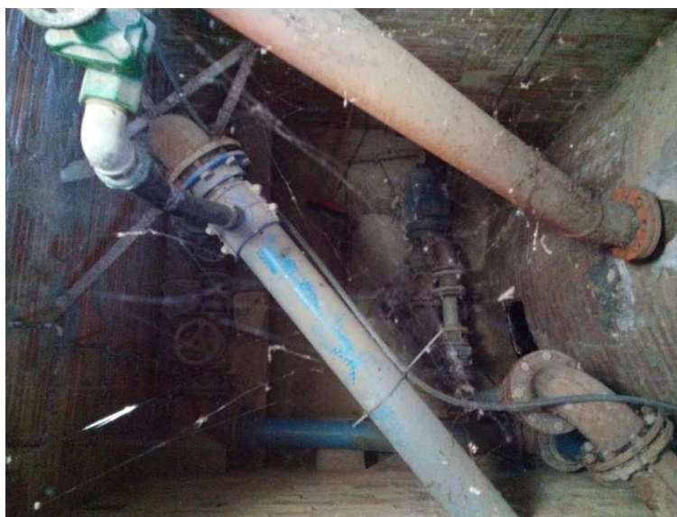
Vista de les canonades situades sota els quadre elèctrics.
