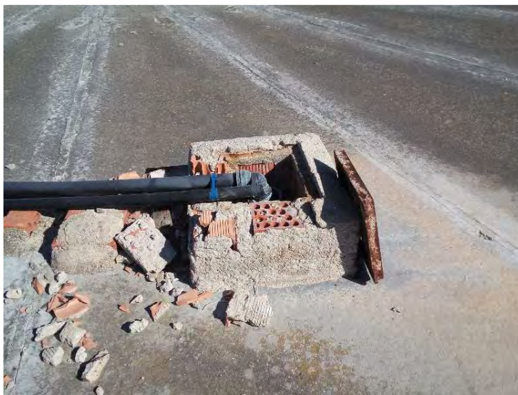
Arqueta de cloració.
