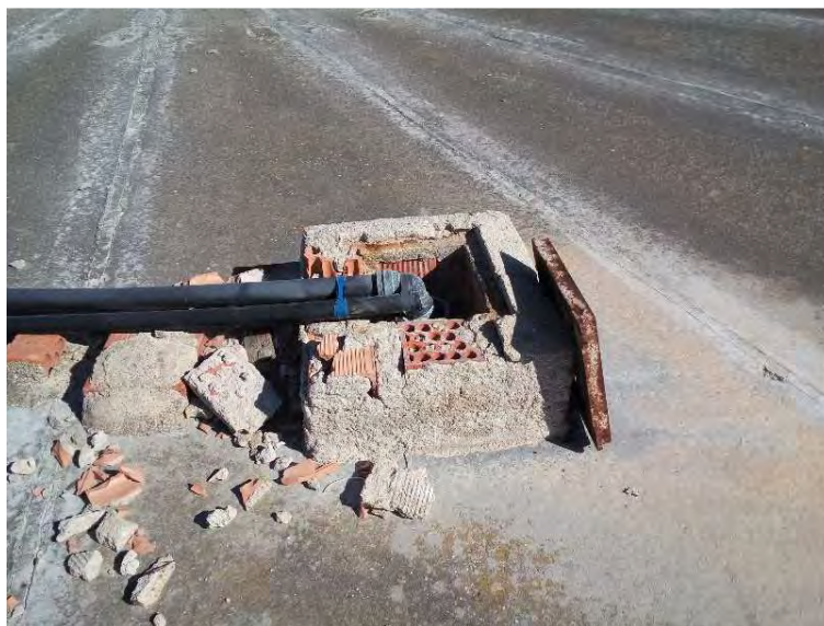
Arqueta de cloració.
