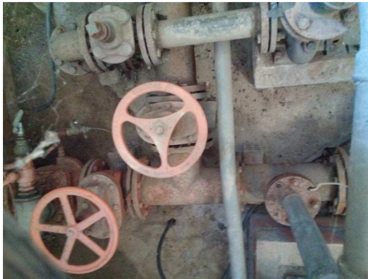
Vista de les re-impulsions de Montornès Nord.
