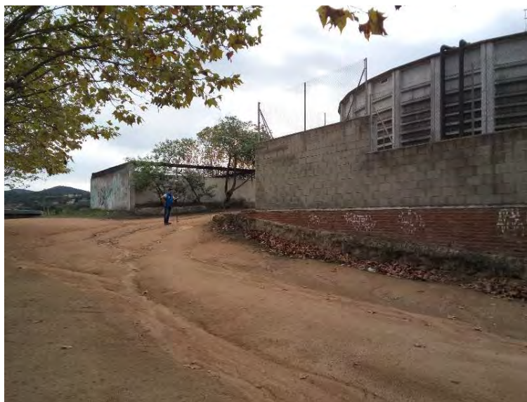
Mur a reforçar.
