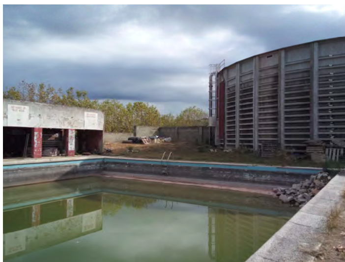
Muret de la piscina que cal reforçar.
