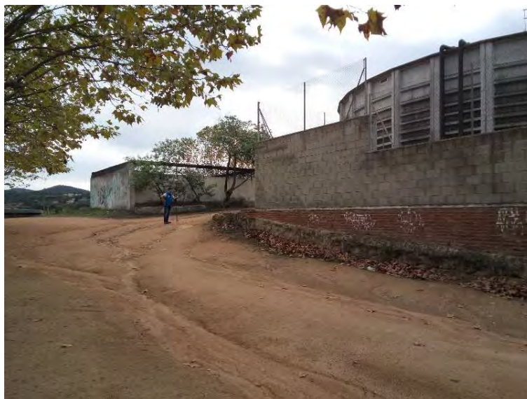
Mur a reforçar.
