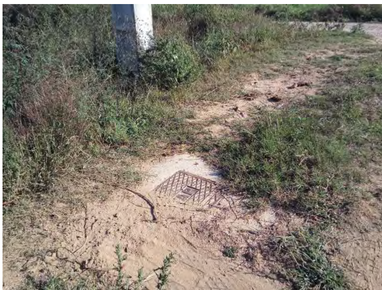
Vàlvula de la impulsió del POU 1.
