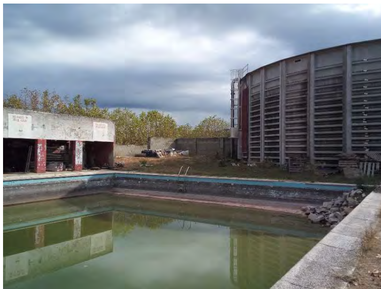
Muret de la piscina que cal reforçar.
