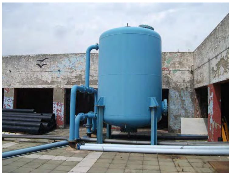
Connexions actuals del dipòsit.
