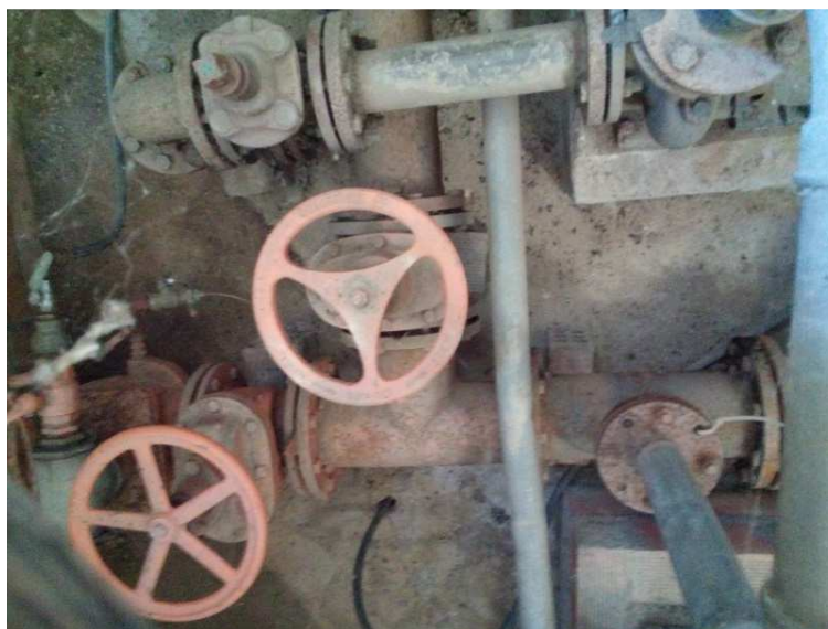
Vista de les re-impulsions de Montornès Nord.
