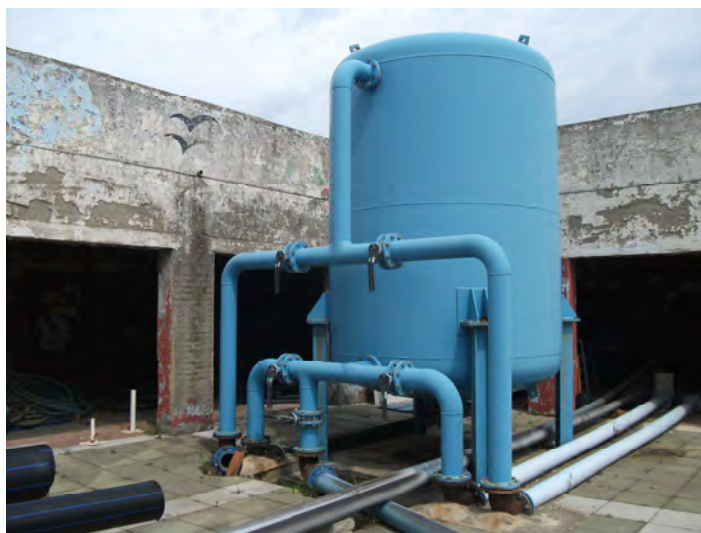
Connexions actuals del dipòsit.
