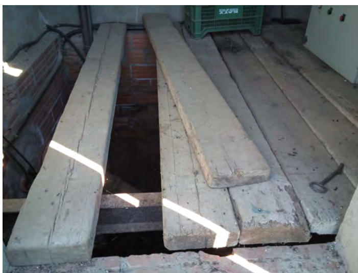
Vista de la cambra de quadres protegida per taulons.
