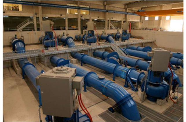
Aspecte de l'interior de l'Estació de Bombament de Rialb
