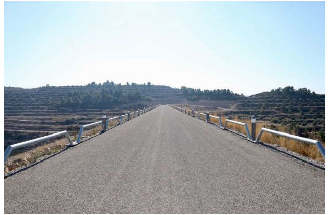
Coronació de la presa amb el DTS barana i balises d'il·luminació
