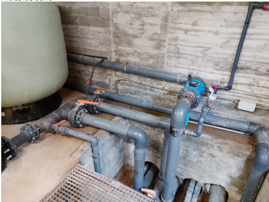
Canonades d'impulsió, retorn i entrada d'aigua de la piscina.
