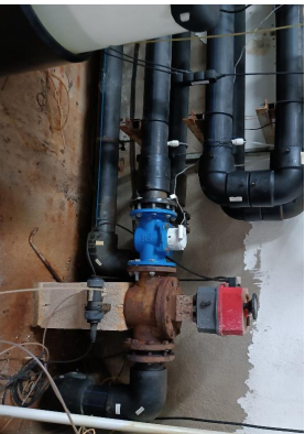
Figura 5: Vàlvula 3 vies i comptador d'entrada
