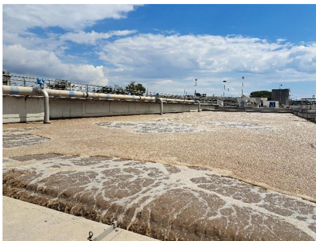
Fotografia 1: Reactor biològic EDAR TGN
