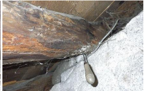
Figura 17. NN_CAB_11. Pèrdua de secció de 20 mm des del cap sud fins a 1,2 m per podridura bruna
