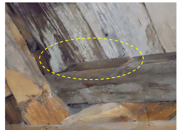
Figura 21. NC_N_CAB_22. Pèrdua de secció de 40 mm per encaix al cap sud (abast 500 mm)
