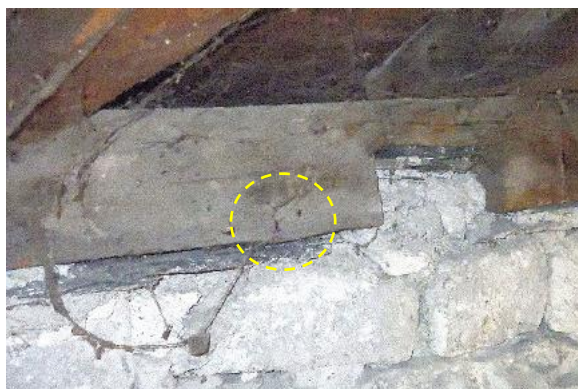
Figura 24. NC_N_CORS_N_3002. Inici de trencament de fibres a 600 mm del cap est
