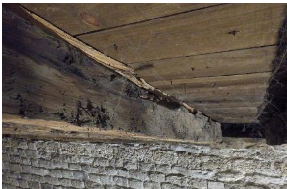
Figura 18. NN_CAB_12. Pèrdua de secció de 40 mm a 1 m del cap nord i fins a 1,9m, per podridura bruna
