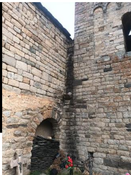
Fotografia actual de la junta entre campanar i façana Sud de l'església, amb la gàrgola traslladada cap a posició inferior i mostrant pel·lícula de biocolonització (Foto: J. Duran)
