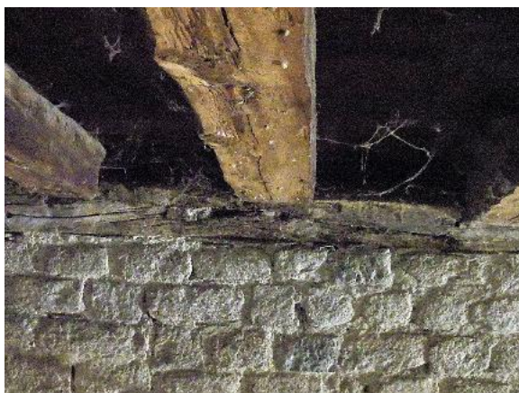
Figura 20. NN_CORS_1005. Podridura bruna sota el recolzament del cabiró 25
