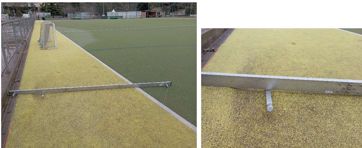
Figura 1. Imágenes del defecto de planimetría encontrado.
