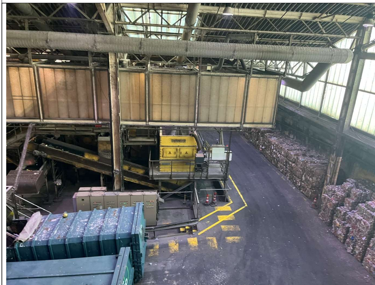
Quadres elèctrics pretractament
