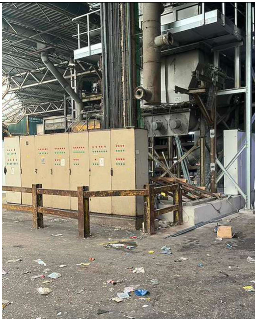
Quadres elèctrics Nau Pretractament
