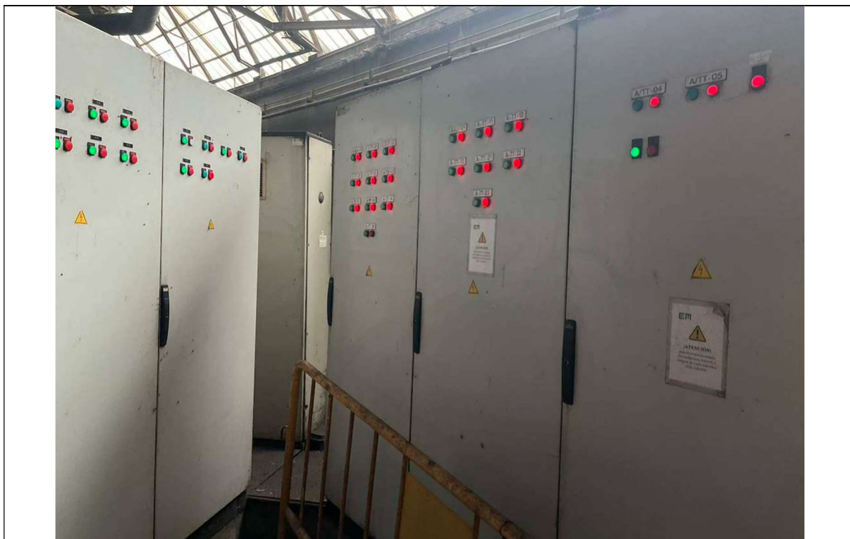
Quadres elèctrics Nau Pretractament
