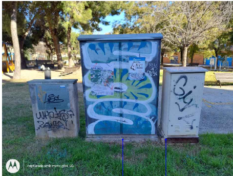
ESTAT ACTUAL BASE ARMARIS TELEFONICA I ENLLUMENAT
