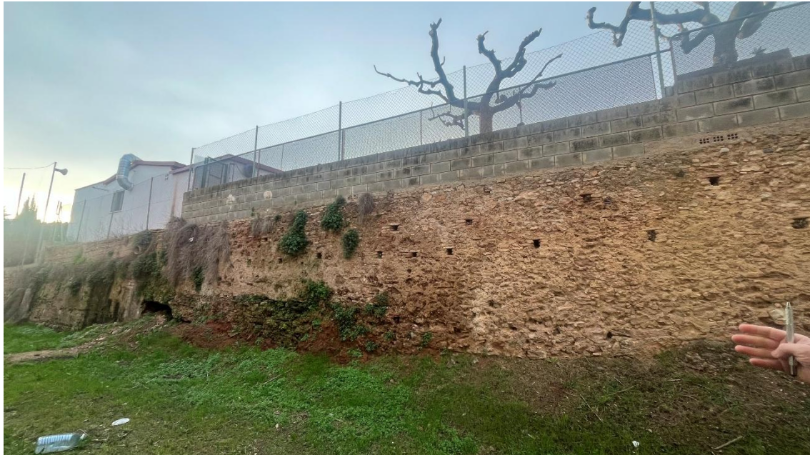
Vista frontal del mur, presència d'humitats, vegetació, erosions locals, etc...
