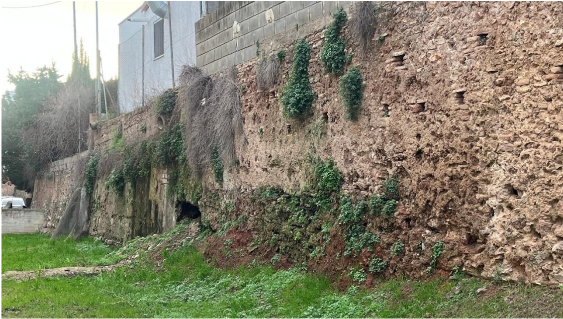
Vista més propera a les erosions localitzades, filtracions i esquerdes del mur actual.
