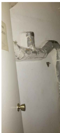
Traster - instal·lacions pre-existents
