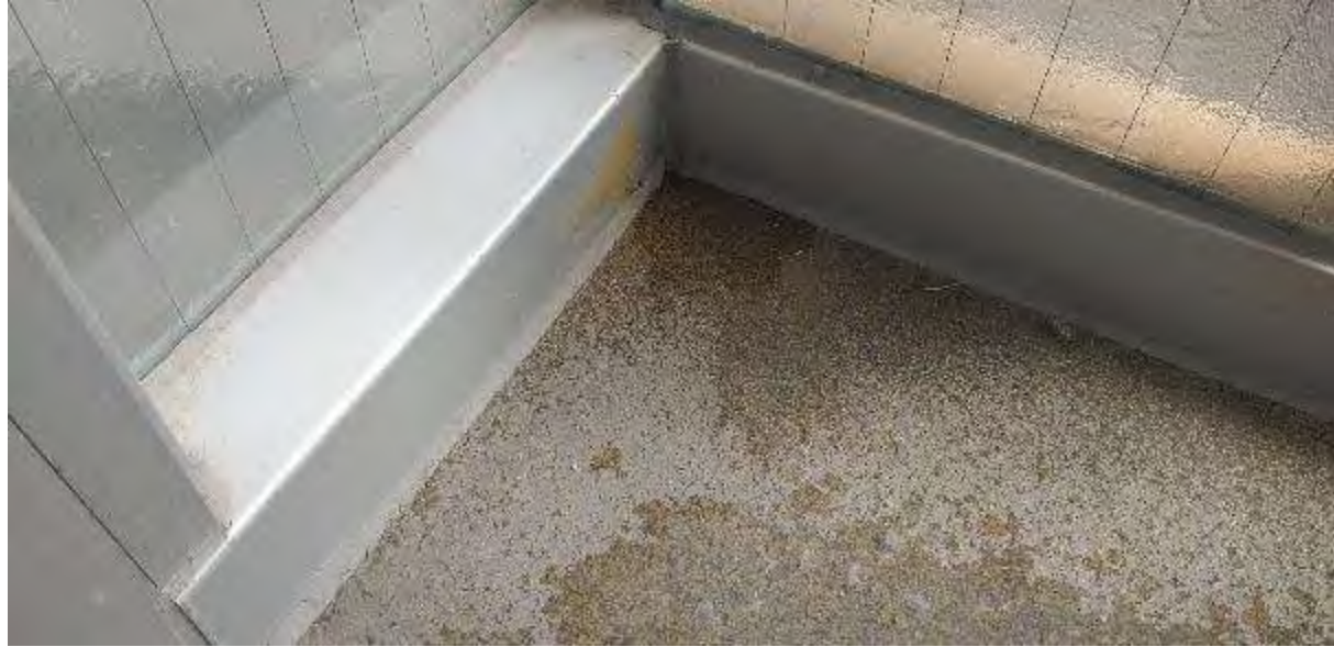
Detall aigua al terra degut a fuga.
