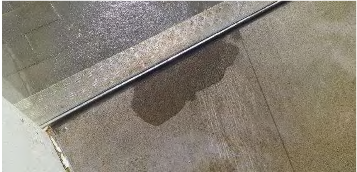
Detall aigua al terra degut a fuga.
