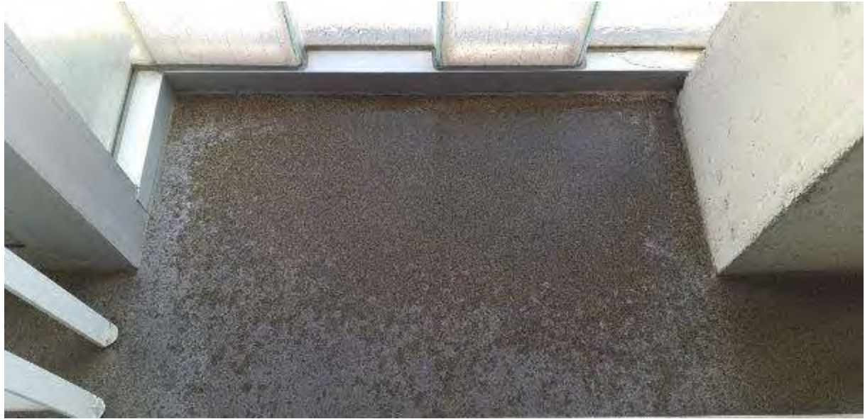
Detall aigua al terra degut a fuga.
