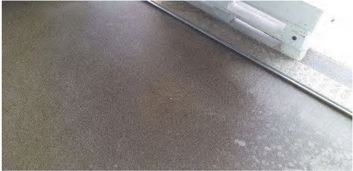
Detall aigua al terra degut a fuga.
