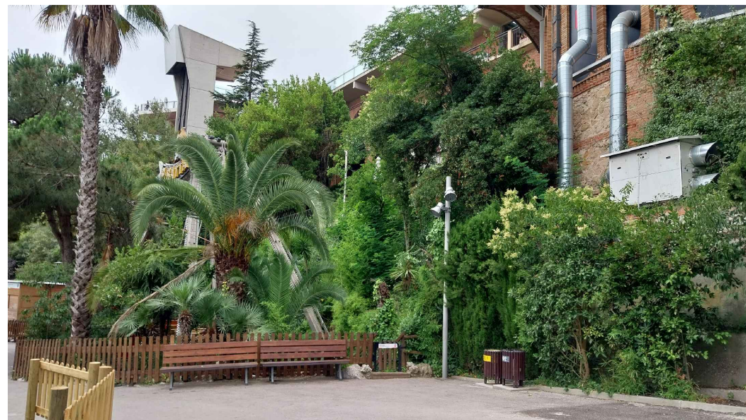
Estat actual instal.lació clima
