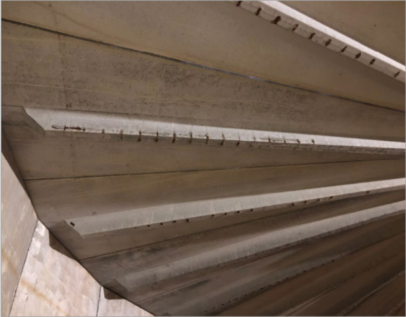
Fig. 7. Afectacions segellat juntes i nervis plaques, on es pot veure barres i estreps a la vista
