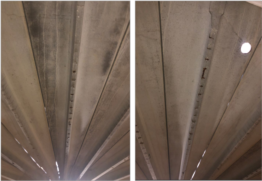
Fig. 4 i 5. Afectacions segellat juntes i nervis plaques, on es pot veure barres i estreps a la vista
