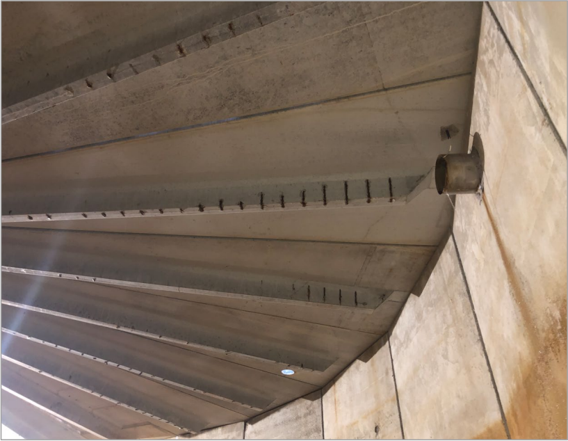
Fig. 6. Afectacions segellat juntes i nervis plaques, on es pot veure barres i estreps a la vista
