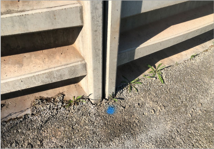
Fig. 24. Afectacions fuites juntes paraments verticals.
