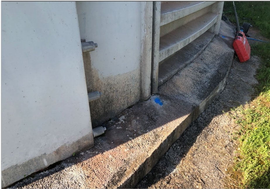
Fig. 27. Afectacions fuites juntes paraments verticals.
