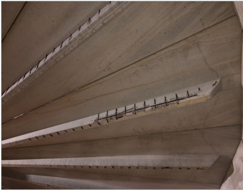
Fig. 1. Afectacions segellat juntes i nervis plaques, on es pot veure barres i estreps a la vista
