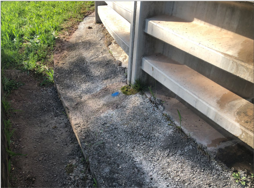
Fig. 25. Afectacions fuites juntes paraments verticals.
