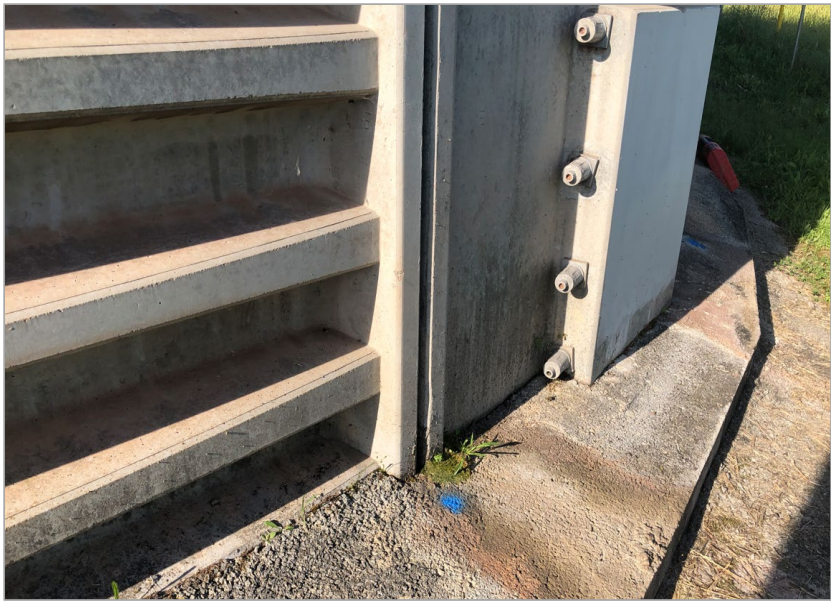
Fig. 26. Afectacions fuites juntes paraments verticals.
