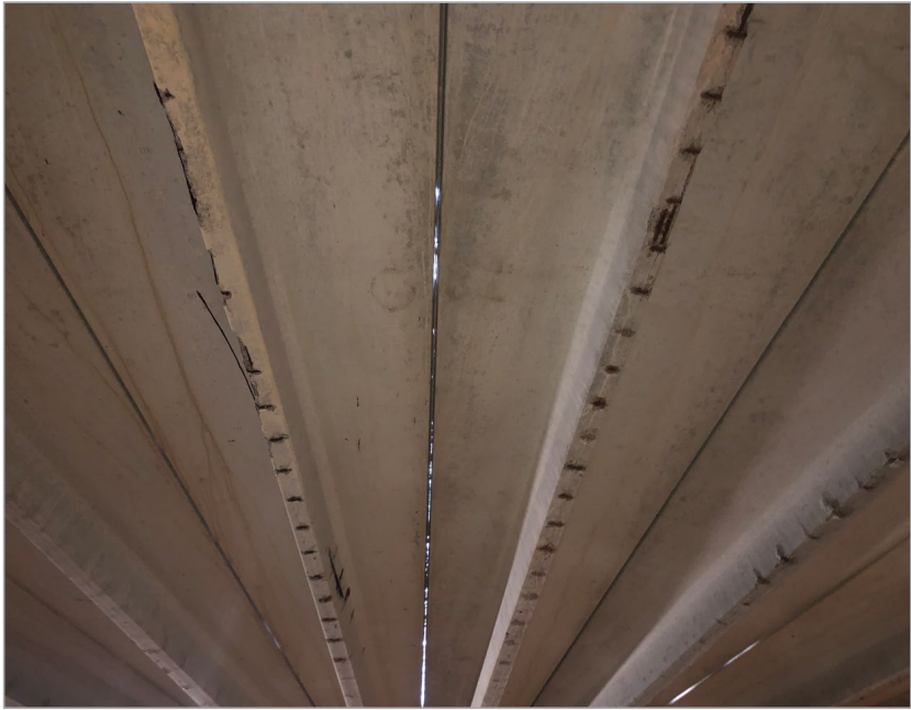
Fig. 3. Afectacions segellat juntes i nervis plaques, on es pot veure barres i estreps a la vista
