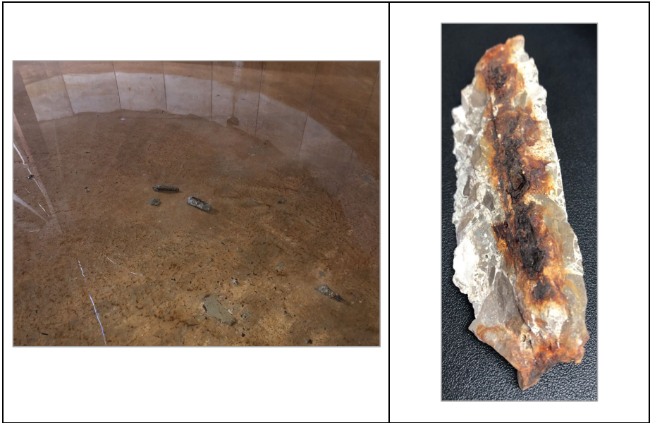
Fig. 5: Imatges despreniment peces de formigó al fons del dipòsit
