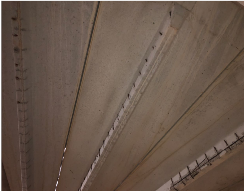
Fig. 2. Afectacions segellat juntes i nervis plaques de formigó armat, on es pot veure barres i estreps a la vista
