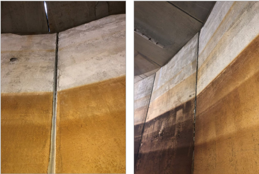
Fig. 11 i 12. Vista paraments verticals del dipòsit on es pot veure afectacions segellat plaques
