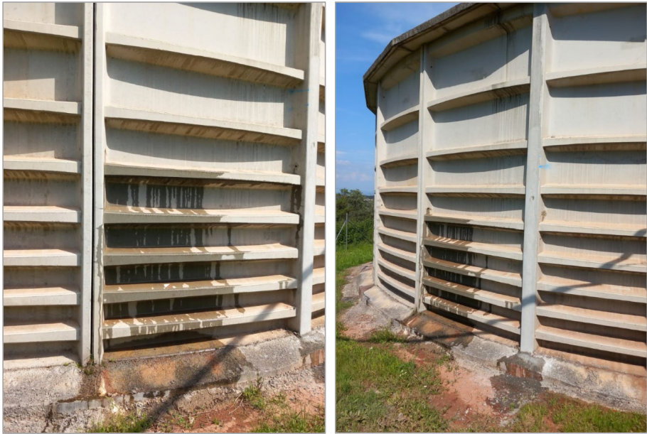
Fig. 18 i 19. Afectacions fuites paraments verticals i juntes del dipòsit.
