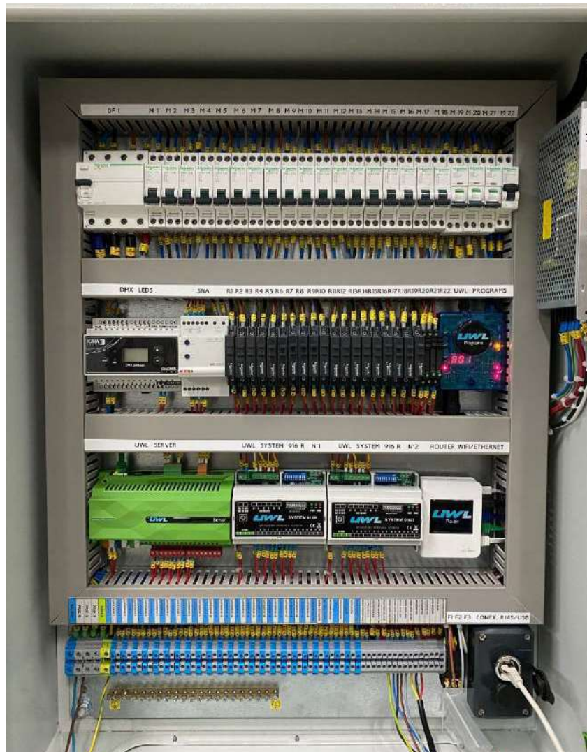
Elements de control quadre elèctric realitzat per Urban Wet Lines
