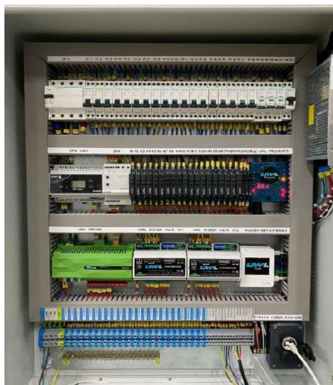
Elements de control quadre elèctric UWL
