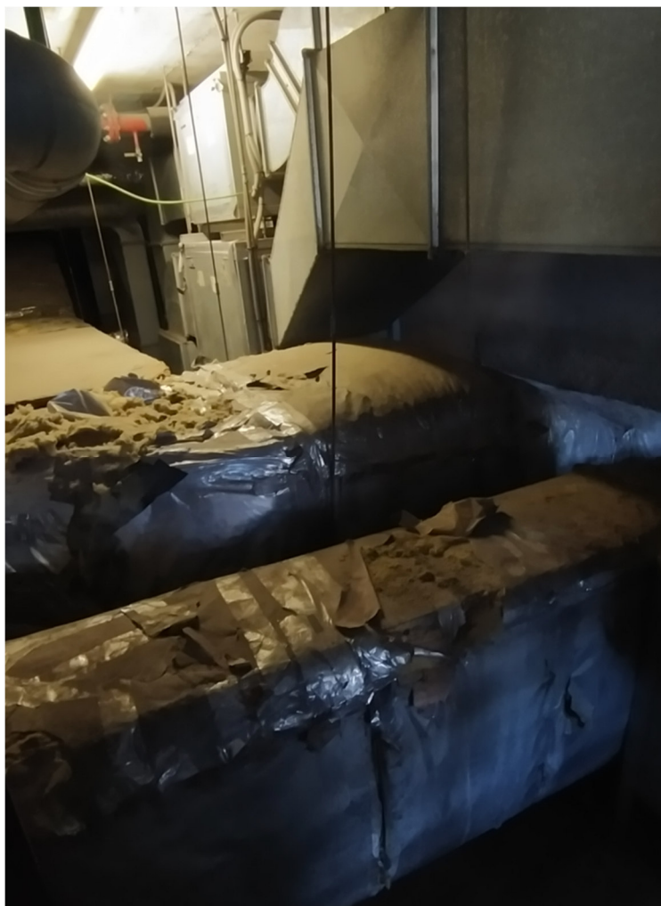
Fig. 5. Ventiladors VE7 i VE19 actuals. Conductes d'impulsió a IRAB.
