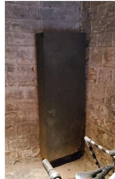
CAIXA PROTECCIÓ CGP
