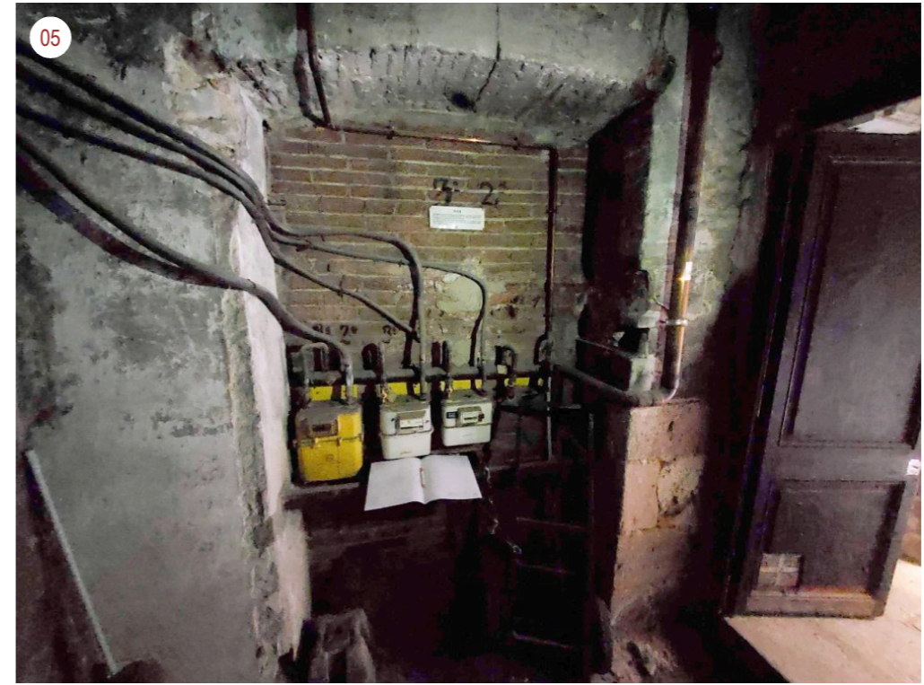
05 QUARTET D'INSTAL·LACIONS. CONTADORS DE GAS
