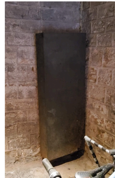
CAIXA PROTECCIÓ CGP
