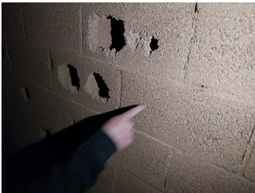
Estat de degradació dels blocs de formigó dels murets separadors.
