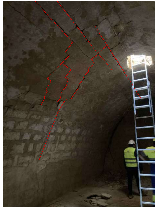
Costat sud de la volta del dipòsit, indicant les esquerdes on actuar
