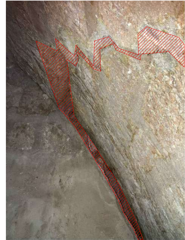
Cantonada sud est de la volta del dipòsit, indicant les esquerdes i separacions on actuar
