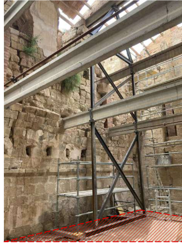
Cantonada sud oest de la torre, indicant la zona de volta on s'actua en el reblert de la volta
