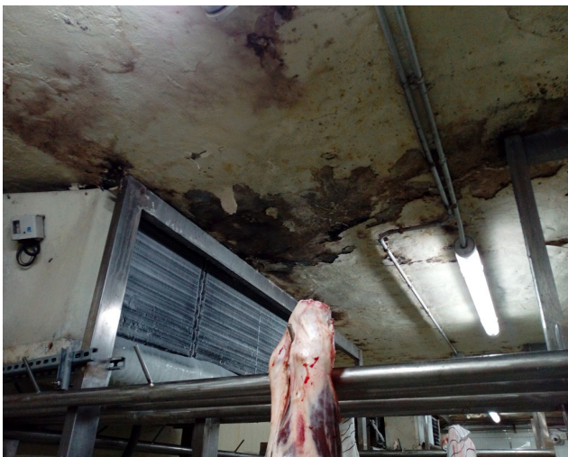
Fig.1 Sostre i evaporador interior càmera carn
