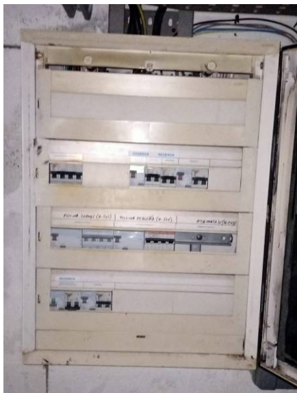
3.- S. Quadre Equip de Filtració
