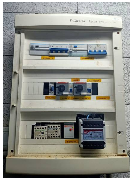
7.- S. Quadre filtració piscina
