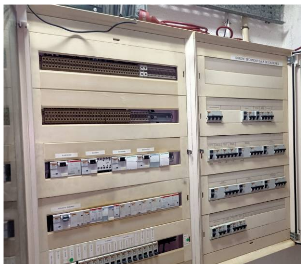
5.- S. Quadre Sala de Calderes
