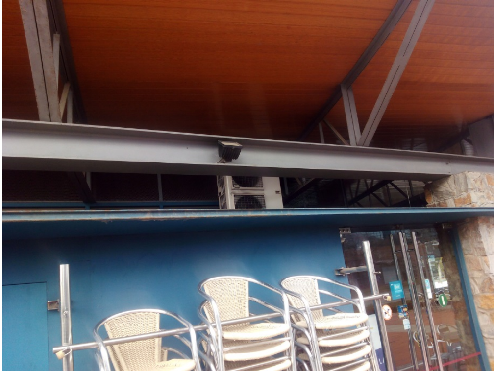
Màquines exteriors d'aire condicionat
