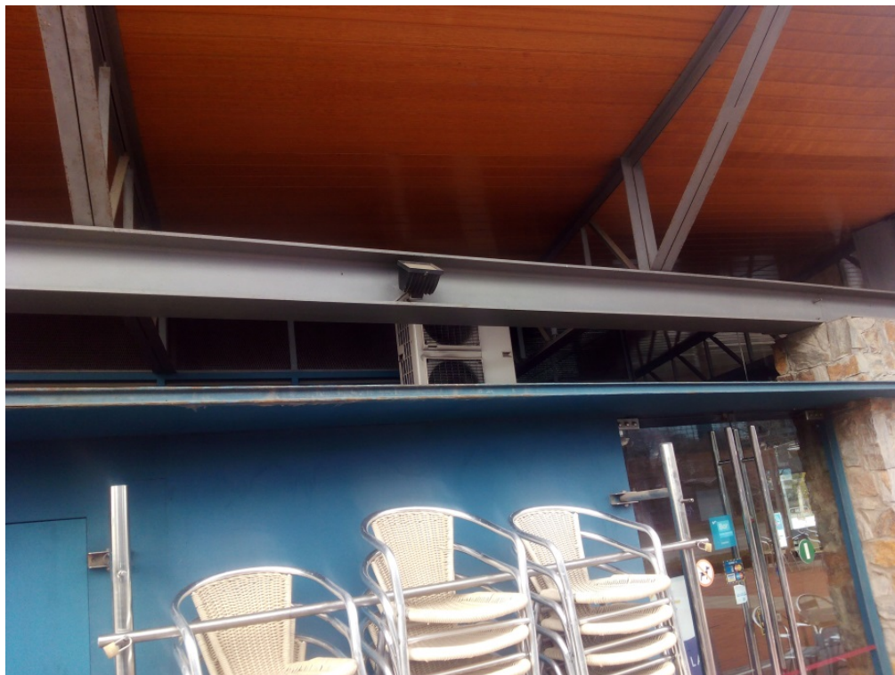
Màquines exteriors d'aire condicionat
