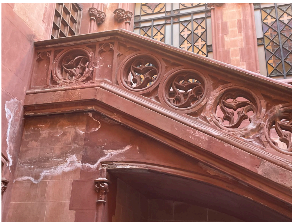
Fig. 4 Eflorescències salines que es filtren pels esgraons, i afluoren en la part inferior de la balustrada.
