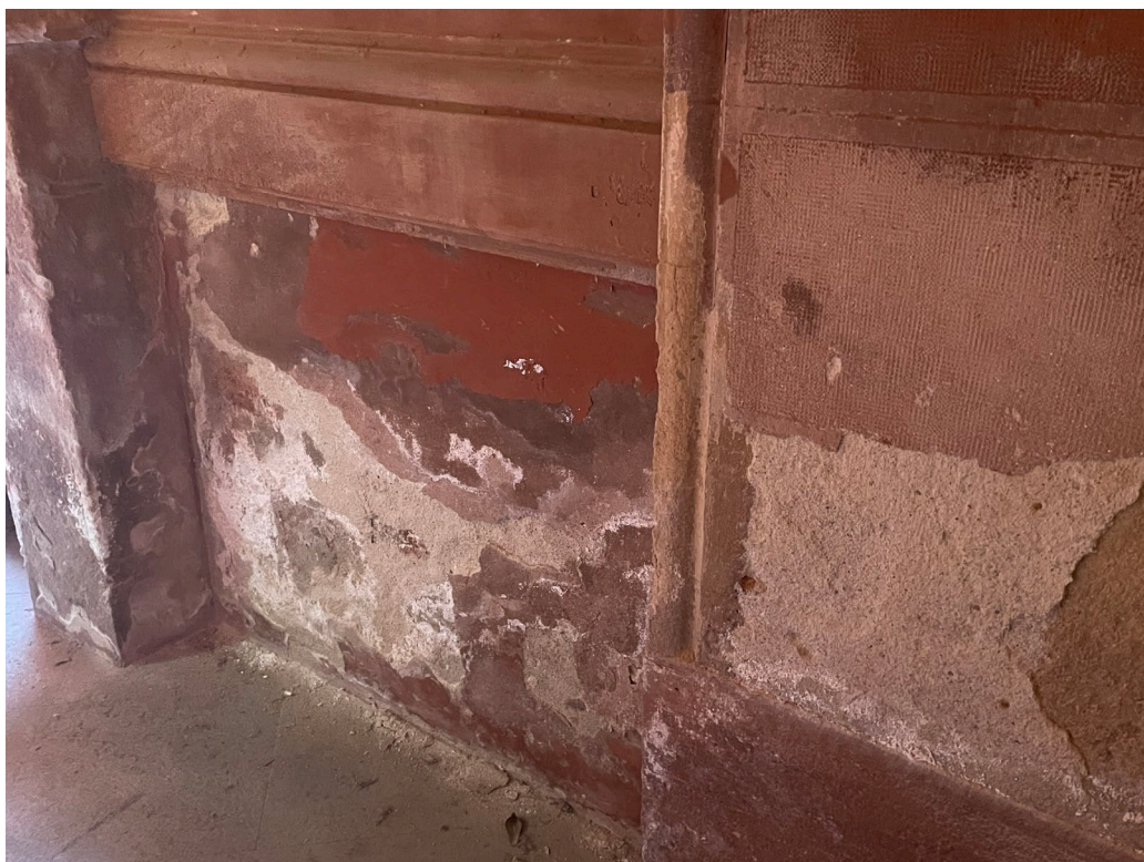
Fig. 3 Eflorescències salines en els sòcals dels paraments.
