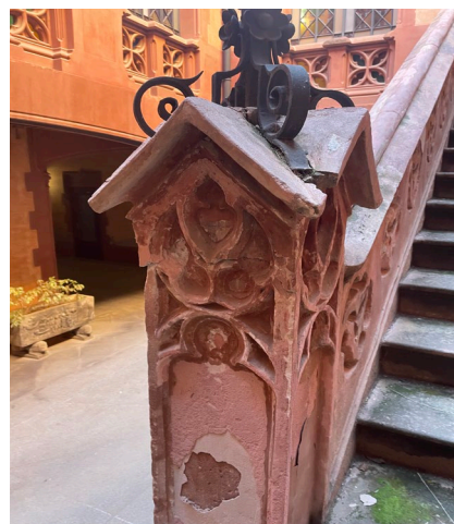
Fig. 8 Trencament exteriors del pilar conseqüència de la corrosió interior del metall.
