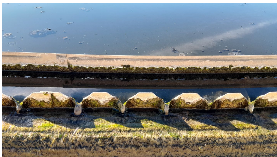
Està del deflector i vessador
