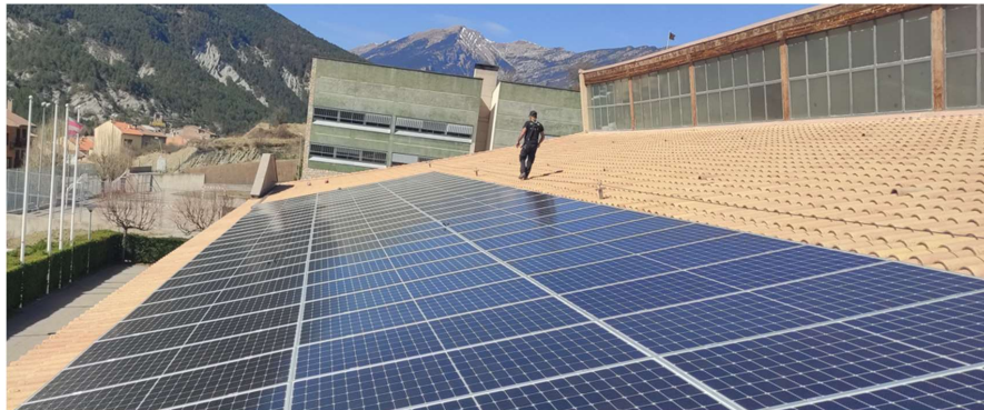
Imatge Camp fotovoltaic
