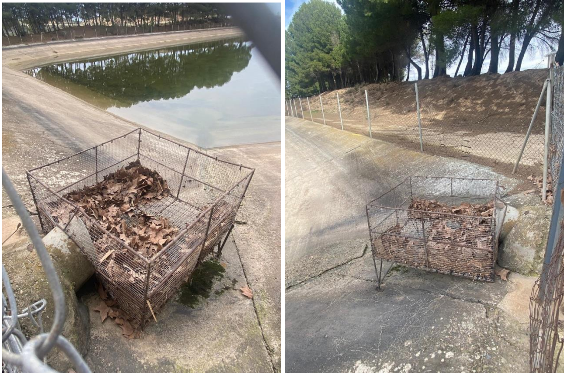
Filtre de cistella del tub d'entrada d'aigua de la bassa
