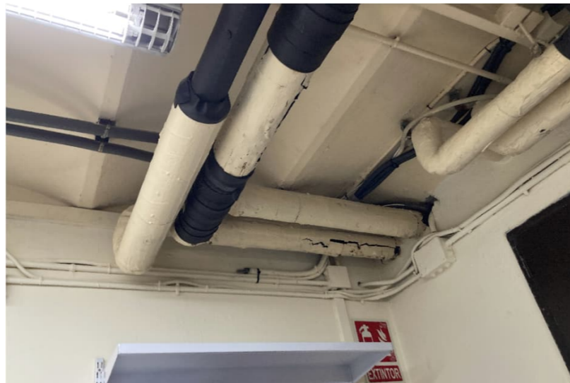
Pèrdua de temperatura per grans recorreguts de les canelles d'aigua i aire. Impulsió i retorn. Canonades corroïdes. S'observa nombrosos pegats per fuites a l'instal·lació de clima.
