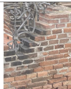
Ús de material incompatible amb la maçoneria original
