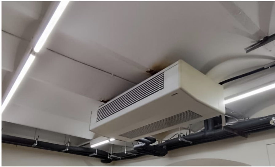
Pèrdua de temperatura per artefactes addicionals al sistema de clima (Fan-coils)
