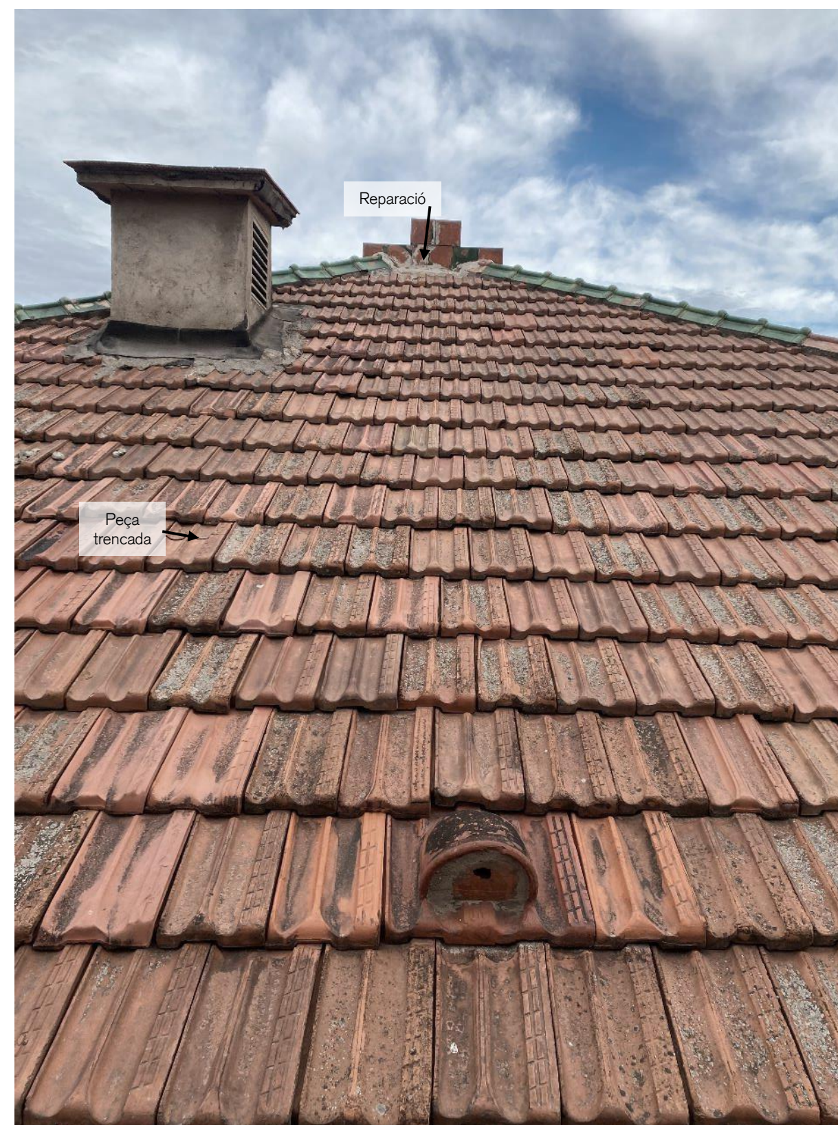
La manca de tela impermeable i les teules trencades asseguren les filtracions.
