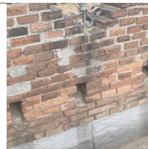
Taques d'escorrenies al mur per manca de conducció de l'aigua
