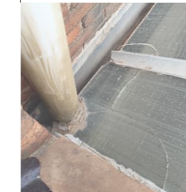
Vidre trencat per trobada mal executada del baixant i la coberta
