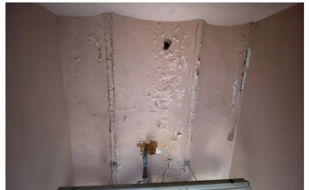
Forjats afectats per pèrdues a l'instal·lació de fontaneria
