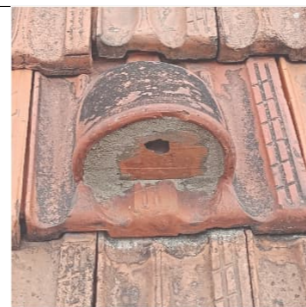
Barrets de ventilació Filtració d'aigua
