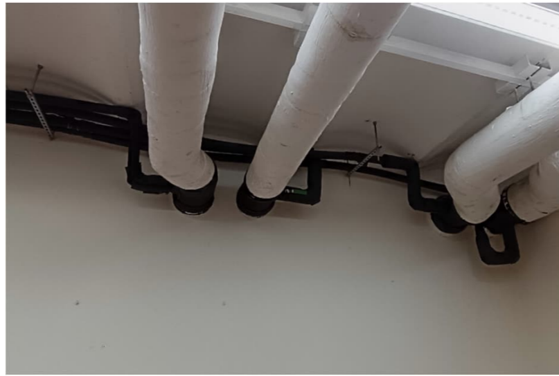
Pèrdua de temperatura per artefactes addicionals al sistema de clima (Fan-coils)
