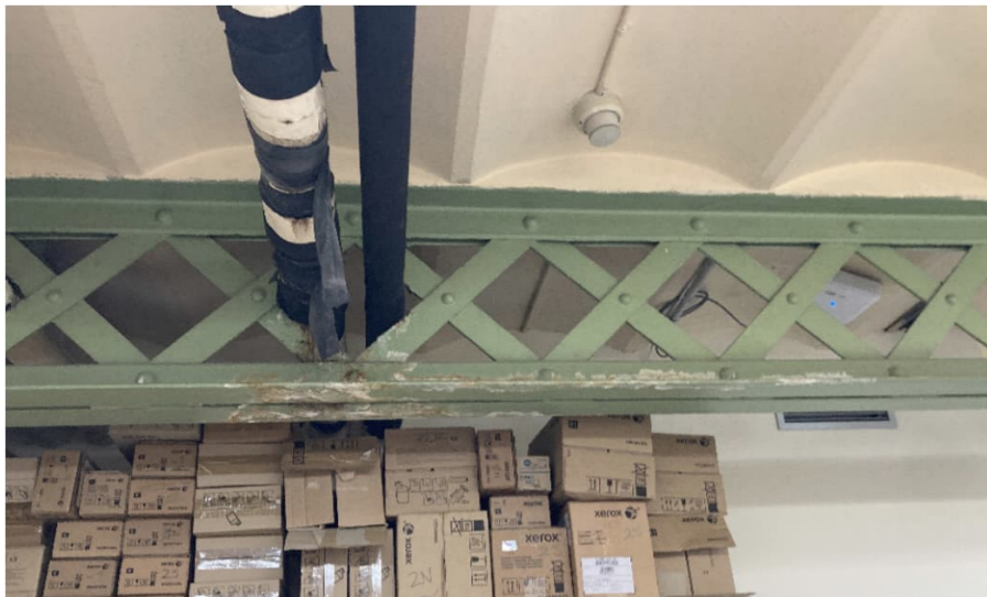
Canelles corroïdes. S'observa nombrosos pegats per fuites a l'instal·lació de clima, la mateixa afecta també a les jàsseres.
