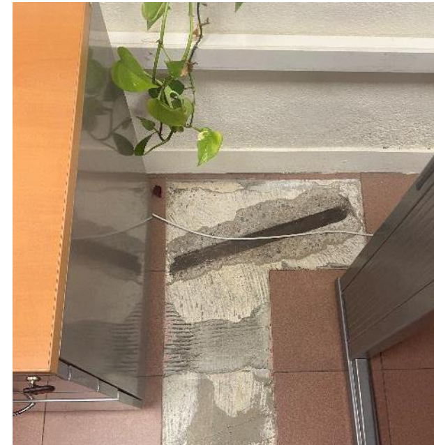
Imatge de rajoles trencades sobre la galeria soterrada del passatge de les canonades de clima
