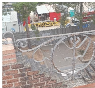
Serralleria oxidada Escorrenia en mur ceràmics
