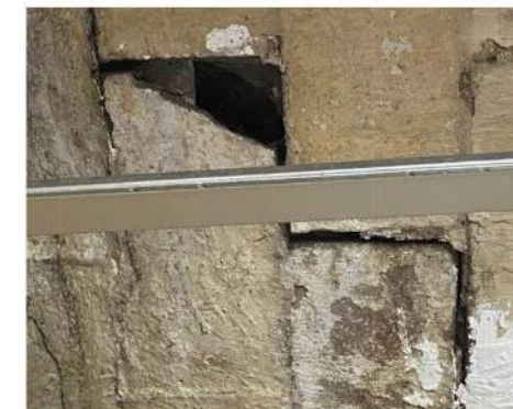
4 - Imatge / cala 4: s'observa dos capes de rajola ceràmica amb presència de tela impermeable perimetral
