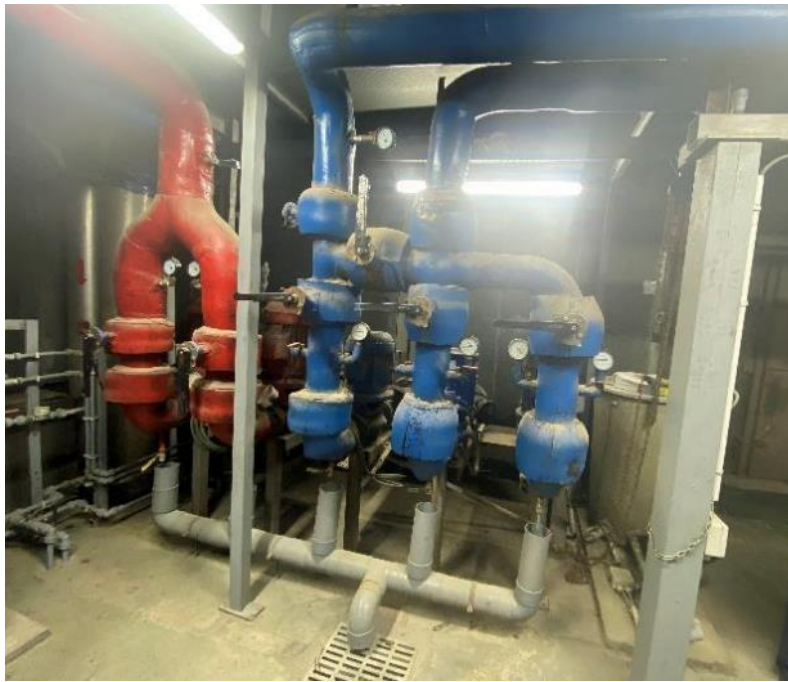
Impulsió d'aigua freda i calenta de la instal·lació de clima
