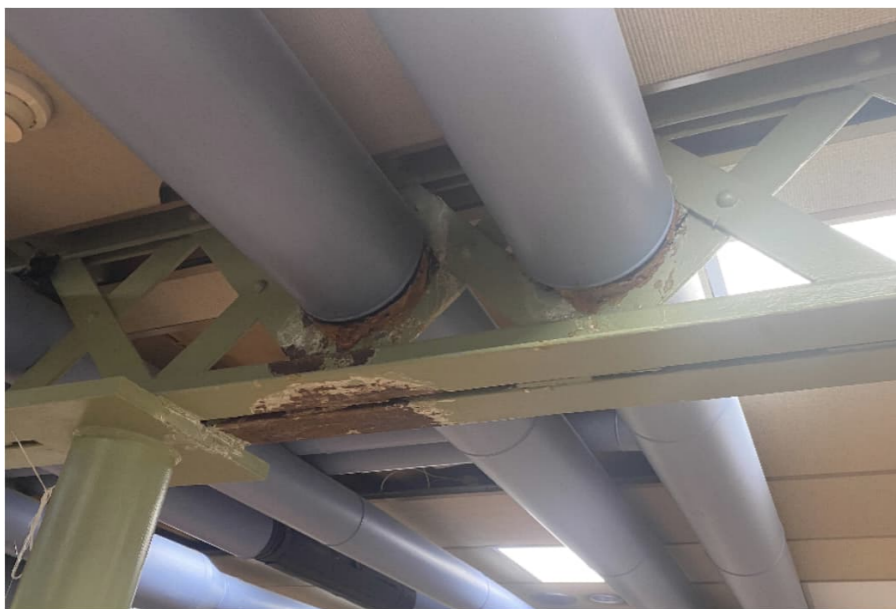
Canelles corroïdes. S'observa nombrosos pegats per fuites a l'instal·lació de clima, la mateixa afecta també a les jàsseres.
