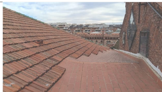
Trobada entre coberta de teules planes i coberta transitable pavimentada amb rajoles ceràmiques
